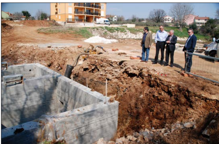
Crpna stanica Puč - Pomer
