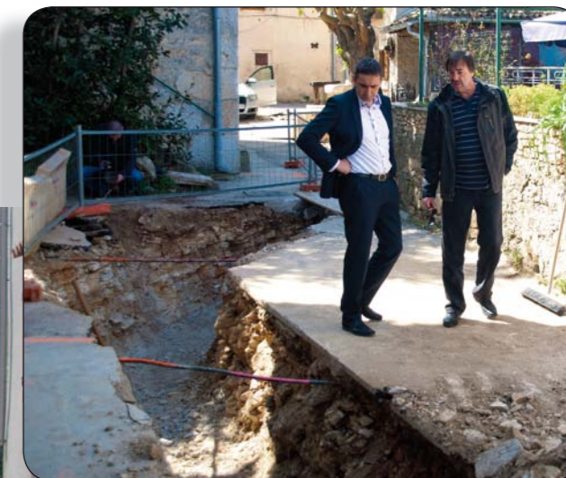
Načelnik Općine Goran Buić i tehnički rukovoditelj Albaneža Vladimir Periša u obilasku gradilišta
